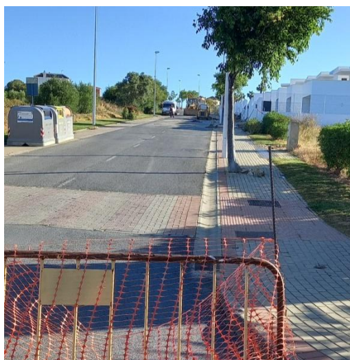
C/ Miguel de Unamuno: calle cortada por obras en la calle, produciendo daños en blandones. Obra realizada por Codelsur.
