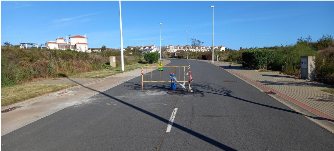
C/ Rosalía de Castro: Hundimiento tapa.
